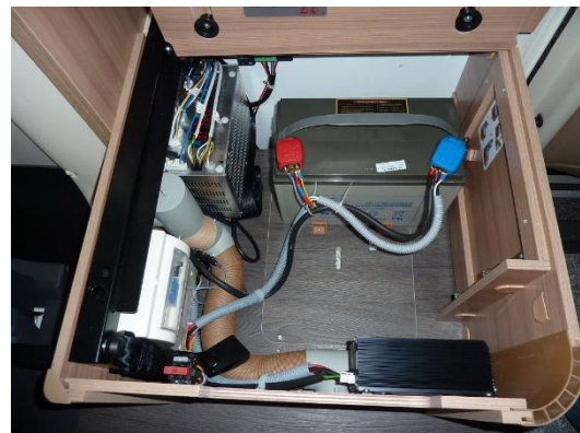
Batterie und Elektronik in Seitensitzbank
