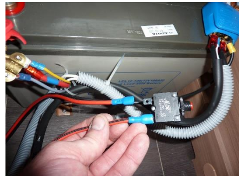
Sicherungsautomat an rotes Pluskabel
